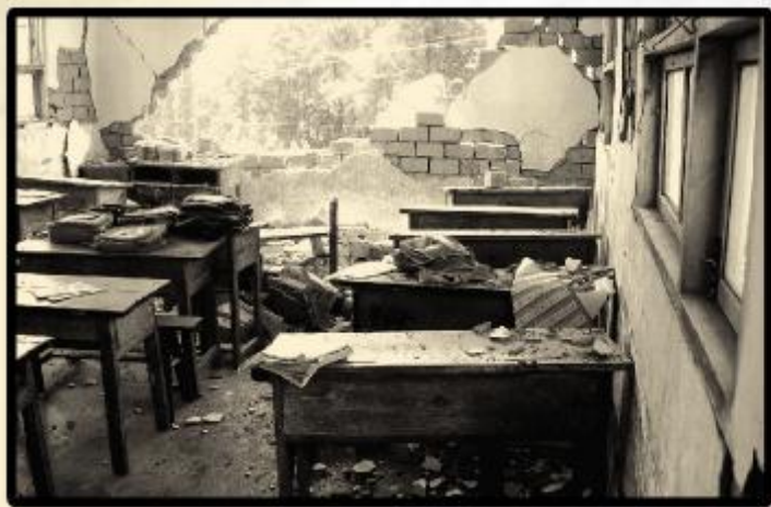
地震中受到重创的雨城区学校一角
